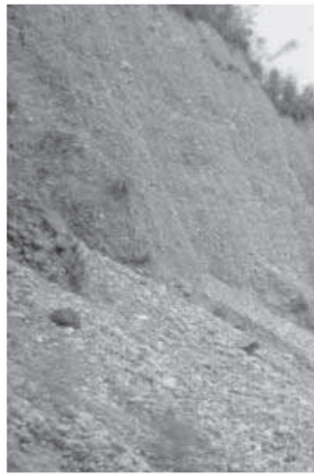
照片二 陡上邊坡的淺層崩落
